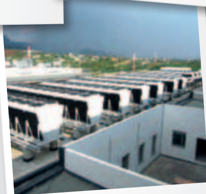
TRAITEMENT D'AIR BLOC OPÉRATOIRE
