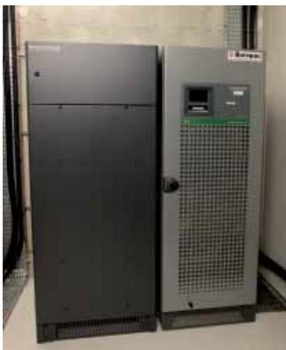
Ici, l'un des onduleurs récemment installés.
